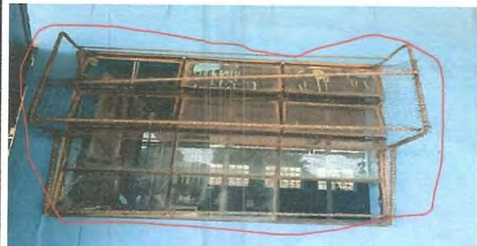
Foto 4: Insalacion de ventanas en mal estado en el primer modulo del establecimiento, a ventanas corredizas de pvc color blanco .
